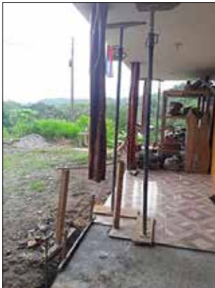
Baumängel: Termiten in den Stützsäulen
